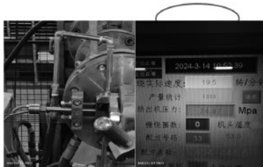
图 2 压力监控装置
